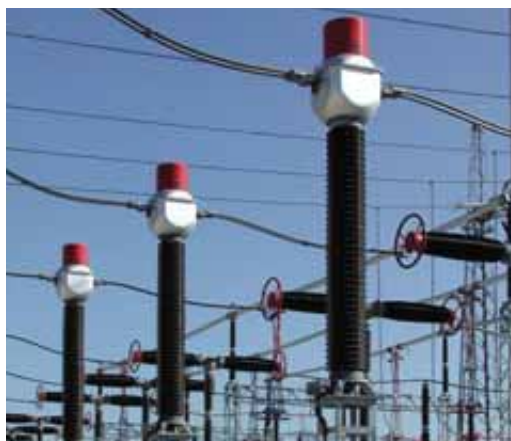
4. 420 kV Current transformers. Rede Eléctrica Nacional (Portugal).
